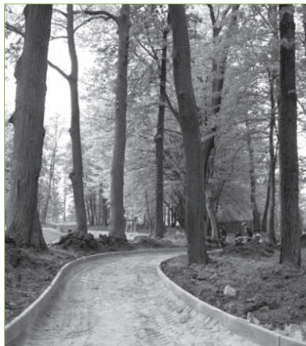
3. Nieuzasadnione głębokie korytowanie dróg parkowych stanowi zagrożenie dla starodrzewu.
